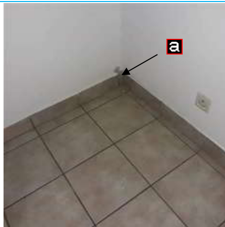
Matériaux : ZPSO-024 Prélèvement : TON 24 Description : Colle de plinthe Localisation : RdC - VILLA 8 - Chambre 1 Résultat : Présence d'amiante
