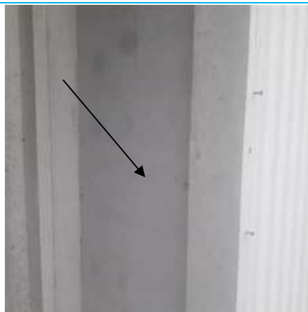
Matériaux : ZPSO-006 Prélèvement : TON 06 Description : Panneaux Localisation : RdC - VILLA 13 - Entrée / façade extérieure Résultat : Absence d'amiante
